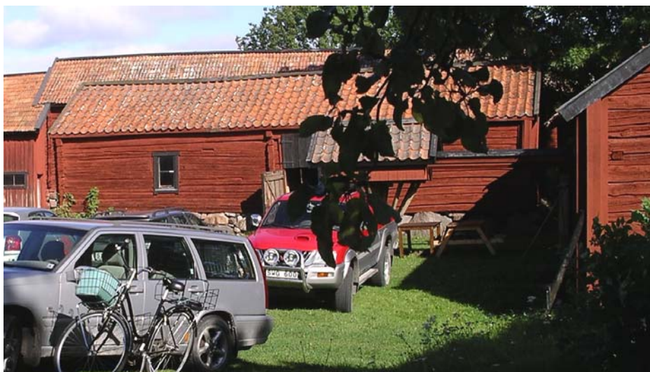
På ladugårdens norra takfall regnar det in.
