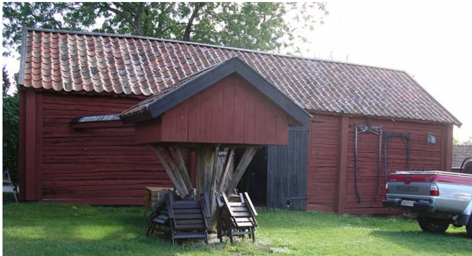
Hela syllen och delar av väggen måste ses över på hela den västra fasaden.
