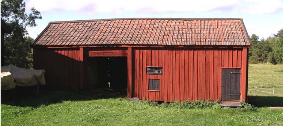
Taket är inte tätt.
