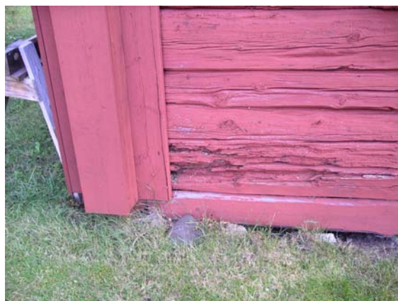
Syllen är rötskadad.
