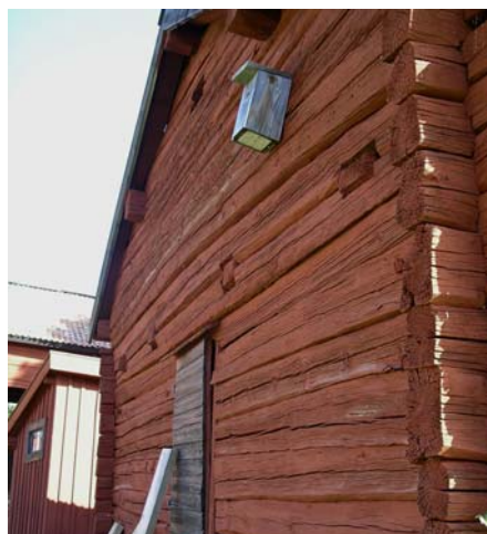
Väggen kalvar ut.
