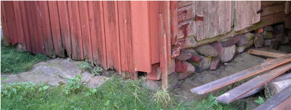
Panelen går ända ned till mark och är rötskadad.
