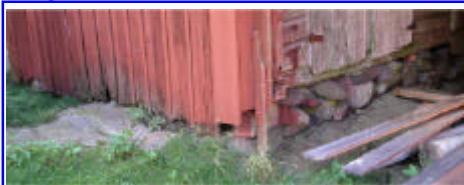
Panelen går ända ner till mark och är rötskadad
